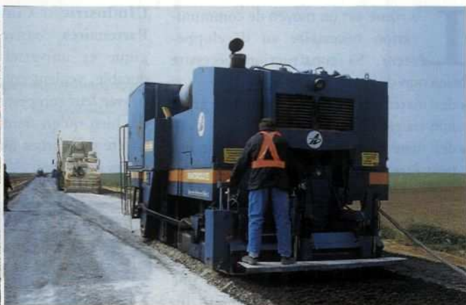
Le retraitement des chaussées en place au ciment ou aux liants hydrauliques routiers épargne les ressources en granulats et supprime les nuisances dues à leur transport.
