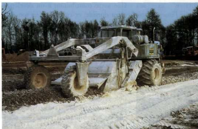
La technique du traitement des sols à la chaux, au ciment et aux liants hydrauliques routiers est de plus en plus utilisée pour les terrassements, mais aussi pour la réalisation des couches d'assises de chaussées.
