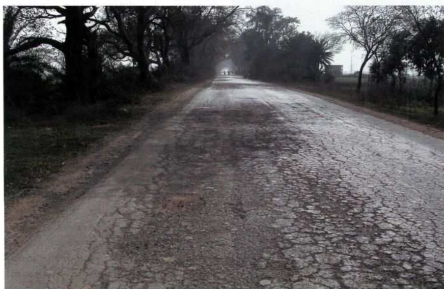
Chaussée dégradée de route rurale au Pendjab
