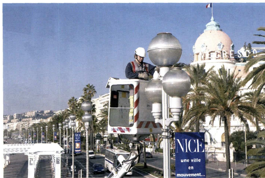
Contrat de gestion globale de l'éclairage public de la ville de Nice
