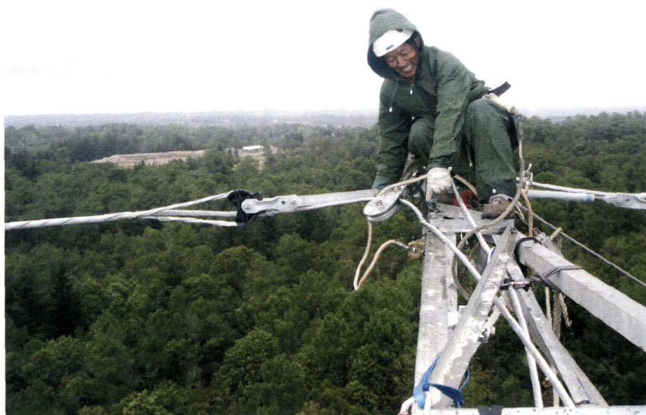
Réseau optique de sécurité pour RTE - Ligne Cordemais-La Martyre (Bretagne)
