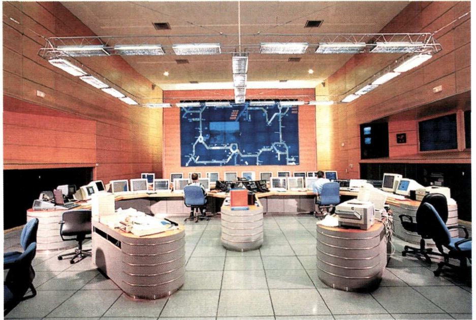
Le centre de contrôle trafic d'Autoroutes du Sud de la France (Source : ASF)
