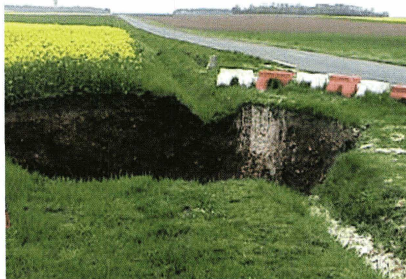
Une marnière sur une route départementale
