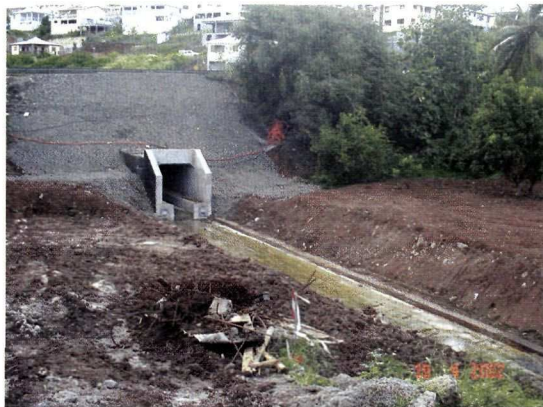
Poussage terminé. Le radier de guidage a servi d'appui au poussage de l'ouvrage pesant 700 tonnes. Il est ancré dans le sol au moyen de bêches.
