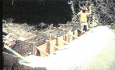
Prise d'eau en rivière
