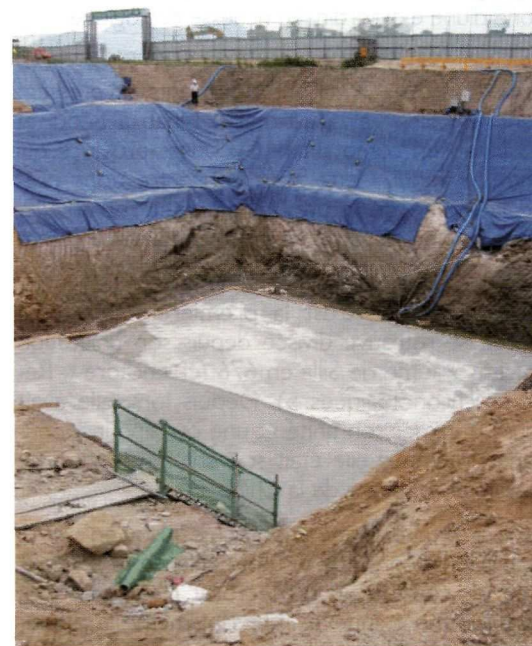
En juin 2003, soit trois mois après le dégel et le début du chantier, les fondations sont faites et les fonds de bassins aussi. Au fond on aperçoit aussi en construction les nouveaux lotissements (appelés en coréen « apateu », de la prononciation coréenne de l'américain « apartment »).
