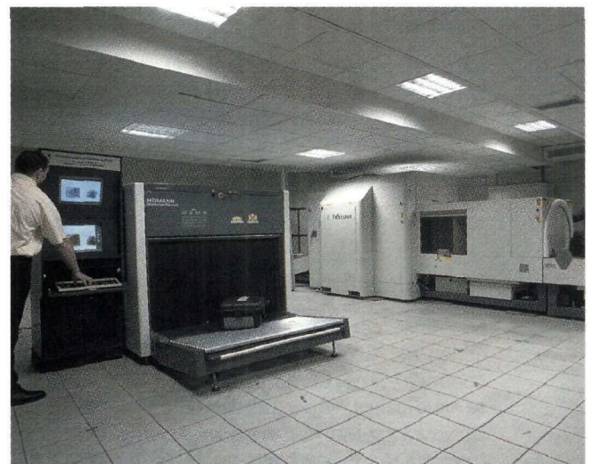
Aérogare passager de Lyon Saint-Exupéry. Salle de contrôle des bagages soute. Photothèque STBA
