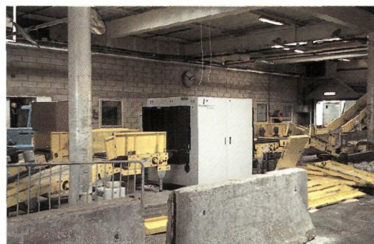
Une intégration d'appareils de sécurité (ici équipement machine X-Ray) nécessite des compétences diverses, du chantier à l'architecture informatique.
