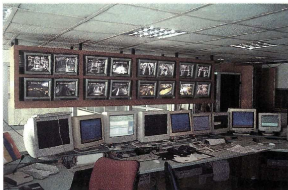
Une des multiples salles de supervision et d'exploitation
