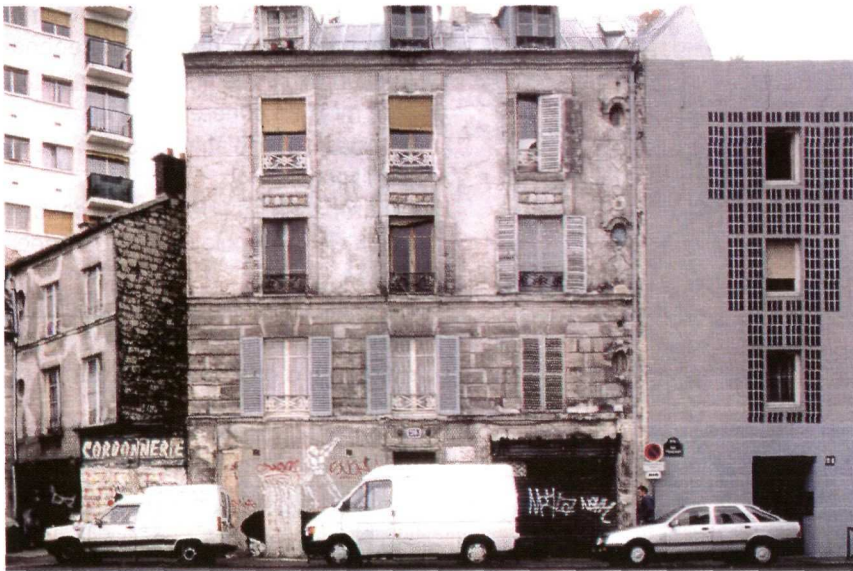
Habitat dégradé en centre-ville (photo SIC).
