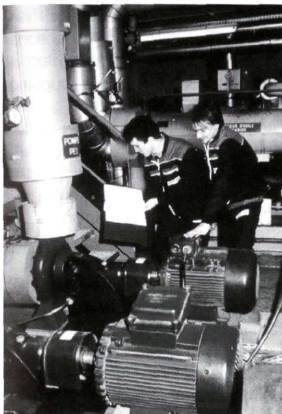
Cogema-Marcoule. GAME-ATM effectue des opérations de maintenance préventive sur les circuits froids des pompes de circulation d'eau évaporateur.
