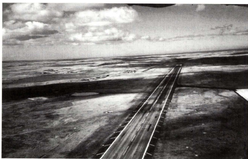
Aéroport des Malouines, réalisé par Colas Ltd (Angleterre). Réfection du revêtement de la piste.
