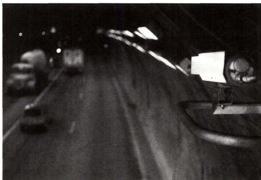
Caméra de surveillance d'un tunnel de contournement de Nice. (Crédit photo : Yannick Collet - ESCOTA).
