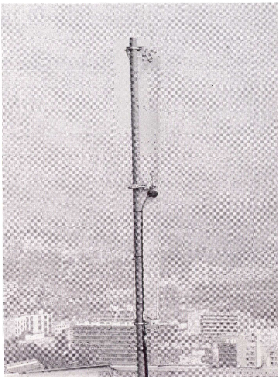
Antenne de radiotéléphone GSM. (Photo Gérard Uferas.)
