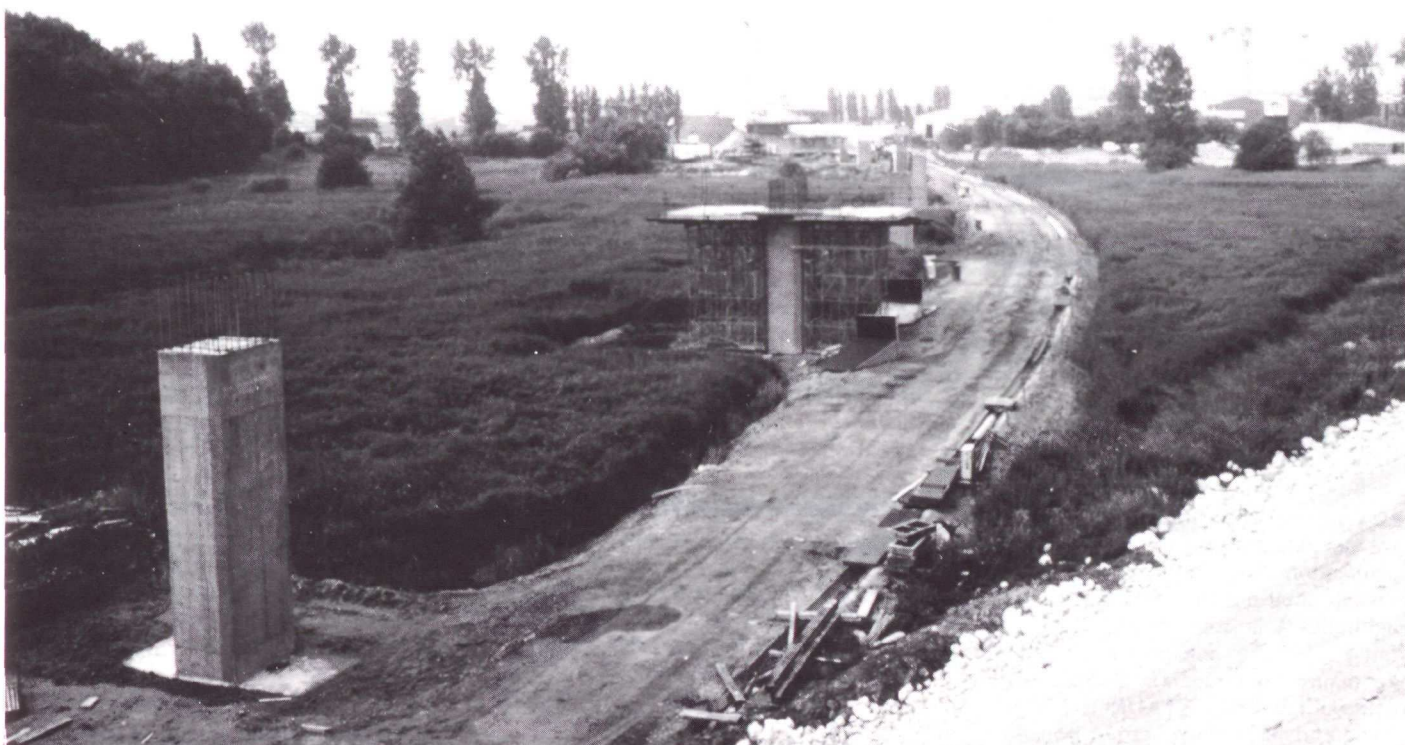
Piste de chantier démontable après construction du viaduc de la Roselière dans le vallon de Roqueville.
