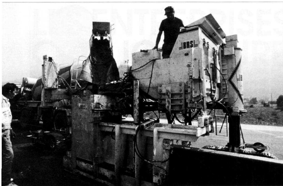
Barrière de sécurité en béton réalisée par une machine à coffrage glissant (B.R.S.).
