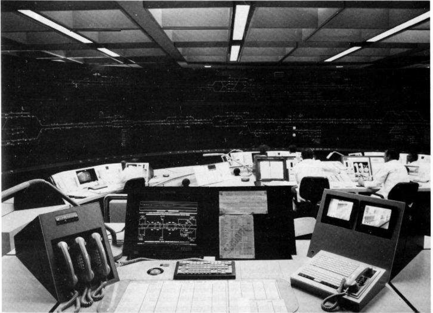
Poste de commande centralisée et de régulation du trafic.
