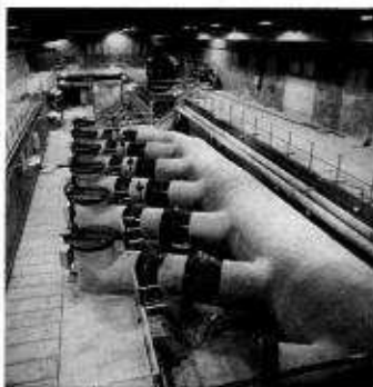
Conduite de refolement.
