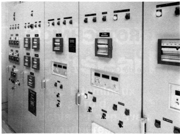
“Armoire électrique de commande”.
