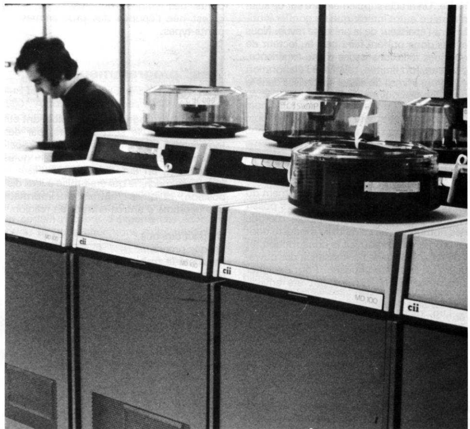
Une batterie d'unité de disques.
