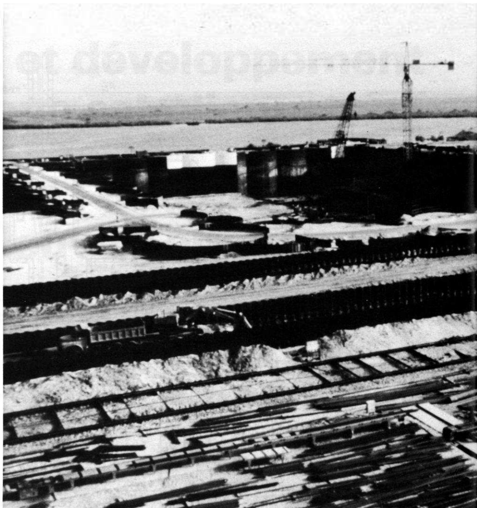
Vue générale du chantier au printemps 84. Au premier plan le sas de l'écluse ; au fond
