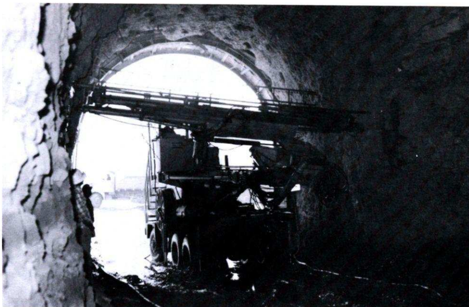
Vidange de fond - Bolonnageau Boltec.
