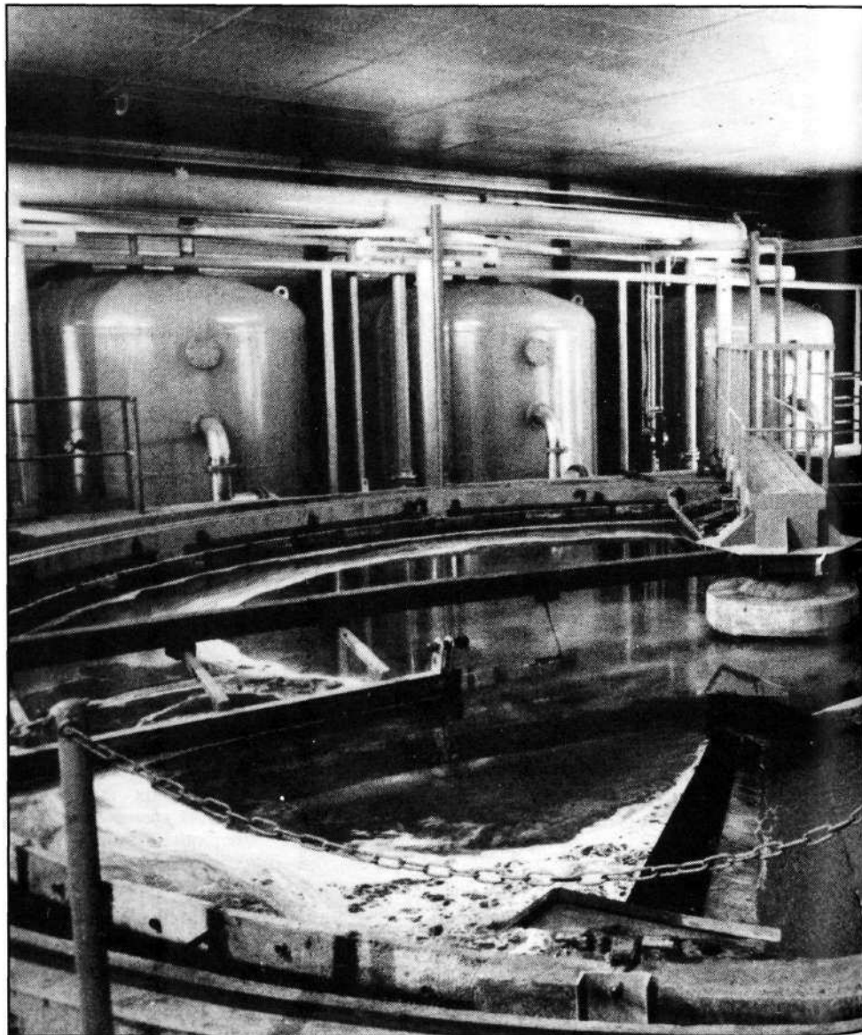
Station d'épuration de BRIANÇON (45 000 hab.). Traitement physico-chimique par flottation suivi d'une épuration biologique par bactéries fixées sur lits filtrants de BIOLITE.
