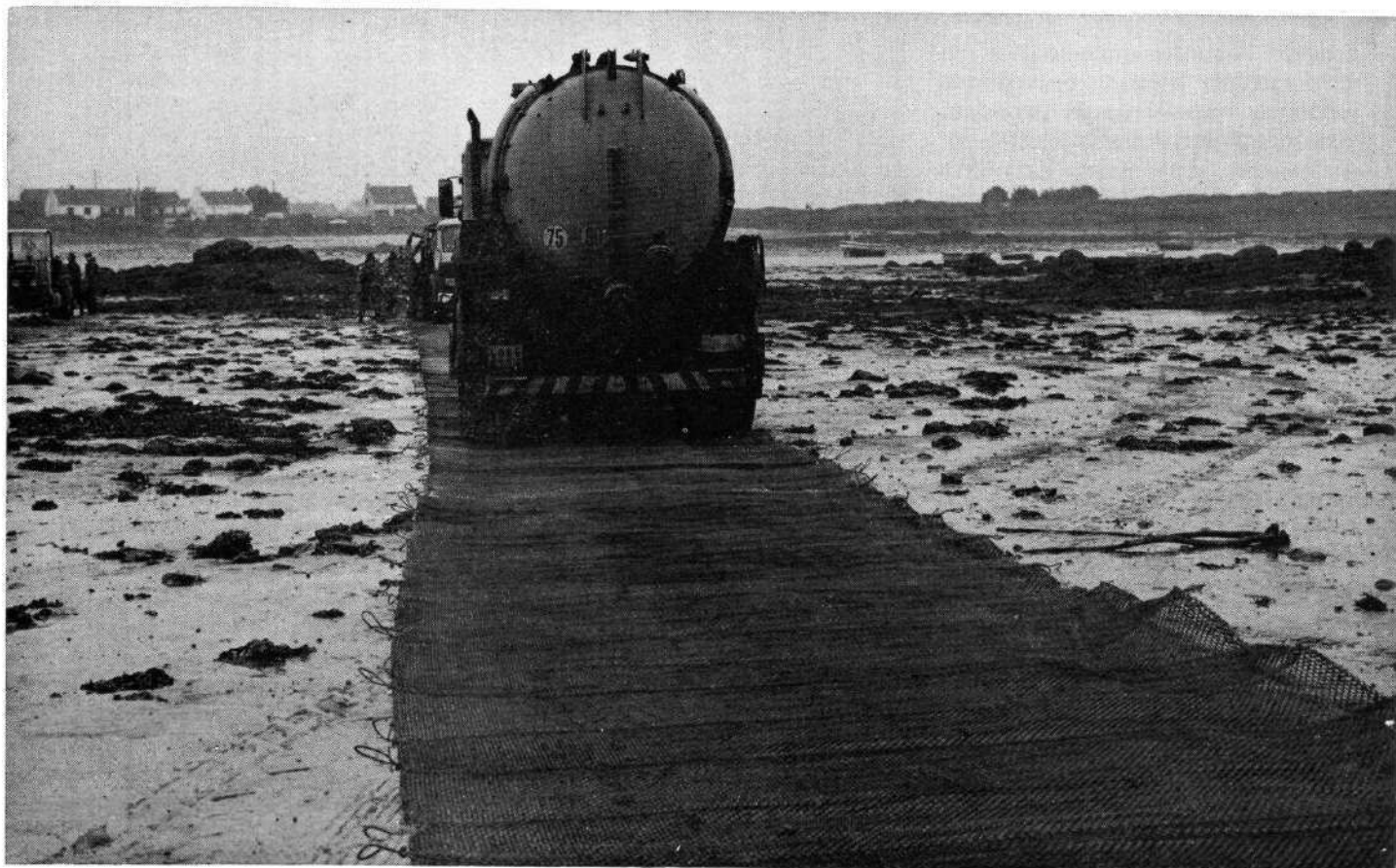
Mise en place de tapis en acier pour permettre la descente des camions d'assainissement sur la plage polluée.
