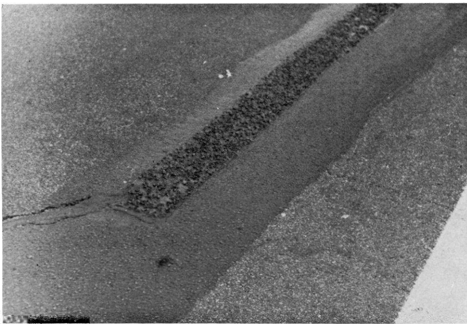
6. - L'enduit EP2 recouvre de façon durable la fissuration des couches de roulement.
