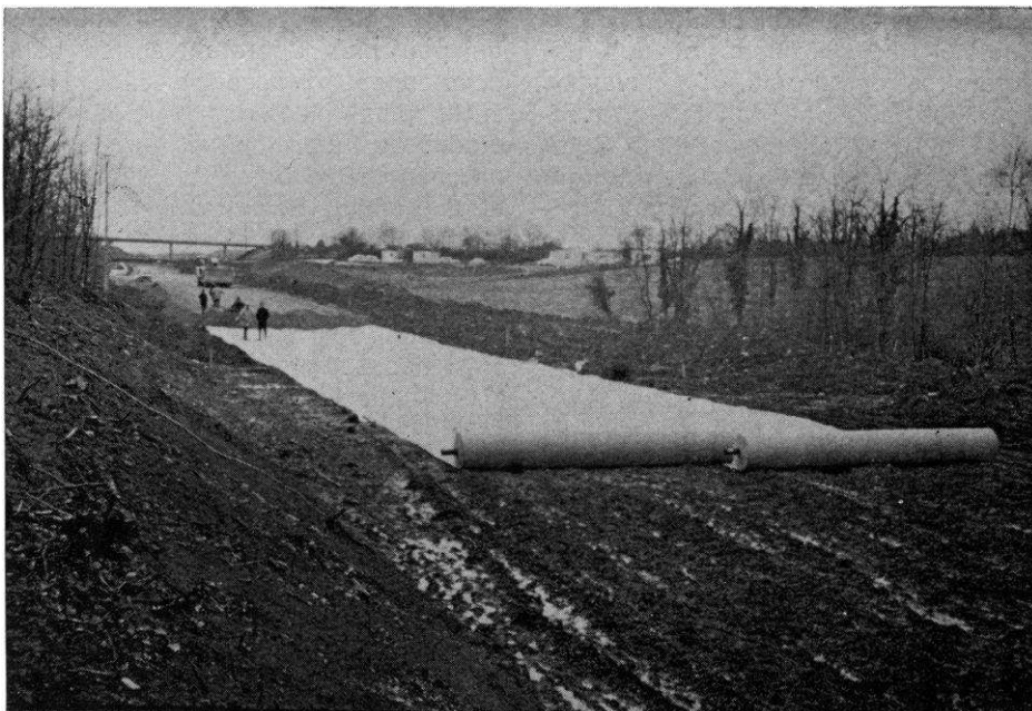
Géotextile utilisé à la base de la couche de forme d'une autoroute.
