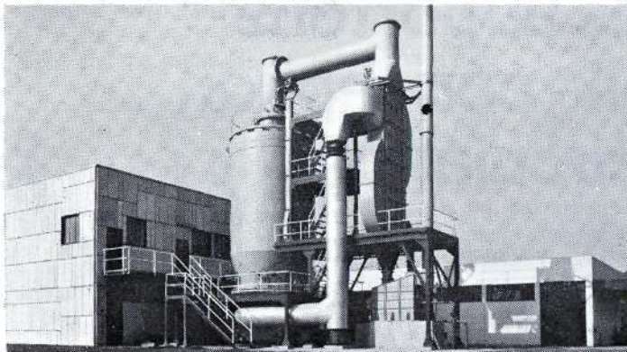
Four à lit fluidisé Station d'épuration du S.I.A.A.R. (Rouen) photo D. Lecomte
